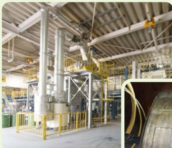
回收淬火炉的废热产生蒸汽
