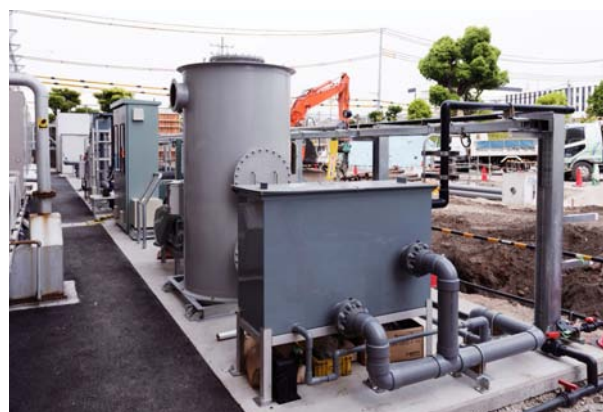
在本公司大阪制作所运转的污水处理装置
