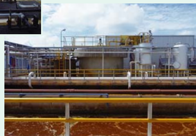
泰国工厂的污水处理装置
