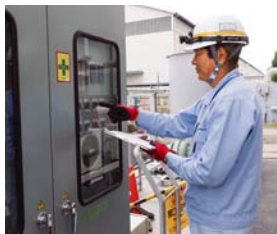
点检装置的运转情况
