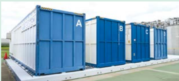
箱型全钒液流电池
