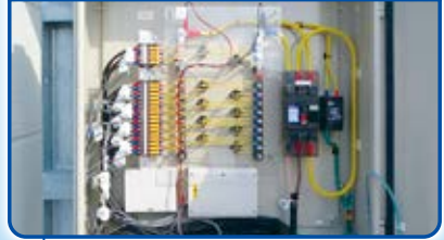
电力线通信 (PLC)
