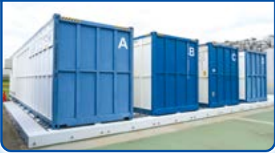
全钒液流电池
