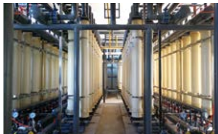
四川省简阳市石盘镇污水处理厂采纳本公司制造的水处理膜组件
