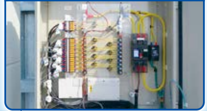
电力线通信 (PLC)
