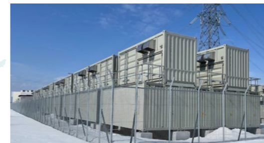
为北海道电网株式会社提供的全钒液流电池系统
