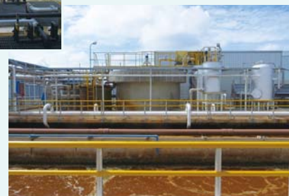
タイ工場の排水処理装置
