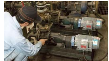
高効率モータの設置
