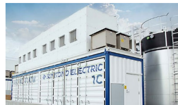
NEDO実証、8,000kWh 2017年竣工
