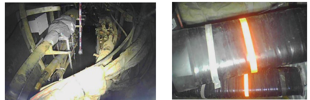
(a) MH内部の全景 (b) ケーブル上のマーカー
