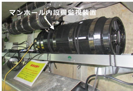
写真3 マンホール内設備監視装置
