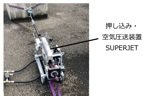
図12 押し込み・空気圧送装置
