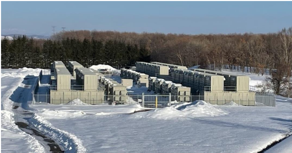
完成したレドックスフロー蓄電池設備
