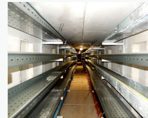
MCF を敷設したラクイラ市内の地下洞道
