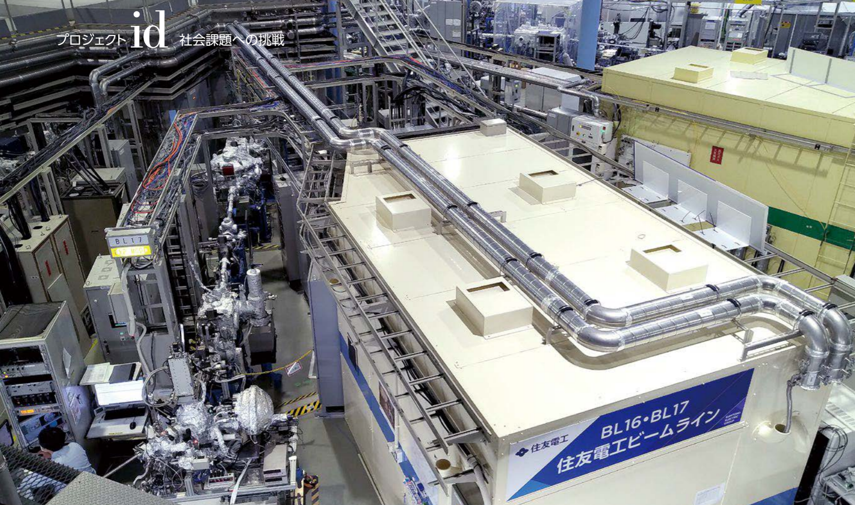
九州シンクロトロン光研究センター内にある住友電工ビームライン(加速器からの放射光を分析に適用するための設備)
