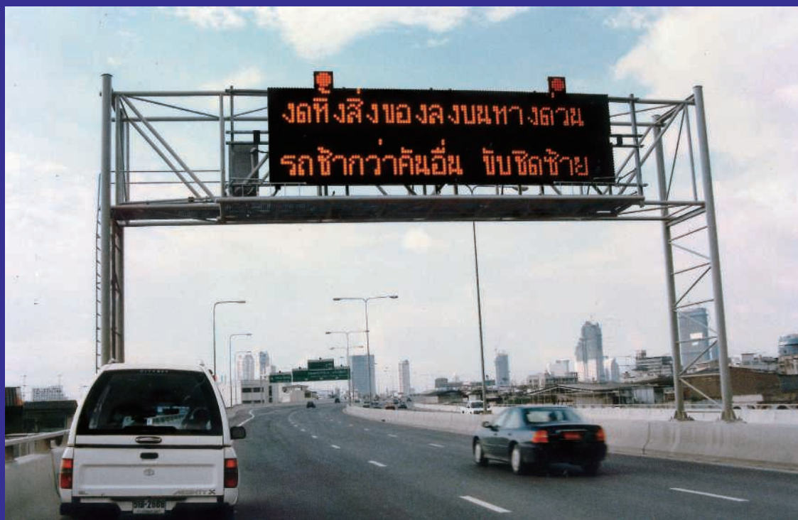
高速道路交通管制システムの多機能表示板
