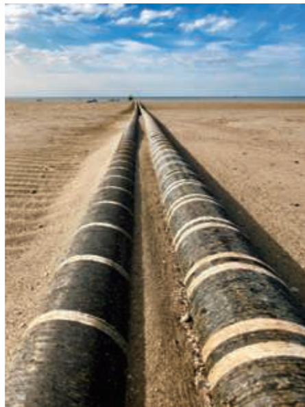
イギリスとベルギーをつなぐNEMOの国際連系線(ケーブル埋設前)
