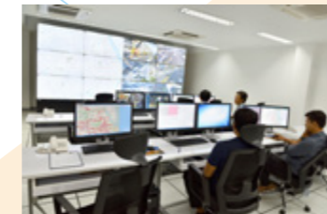
交通管制システム さまざまな交通情報を収集・解析し、信号機の制御や交通情報の提供を行うことで、安全で円滑な交通流を実現します。
