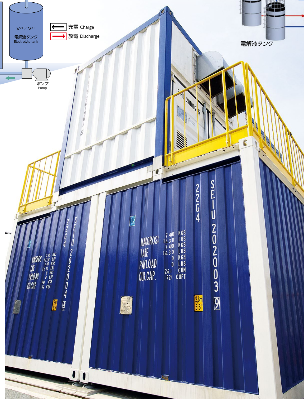
レドックスフロー電池は、1F部分に正極と負極の電解液コンテナ、2F部分にセルスタックが設置された電池盤コンテナで構成される
