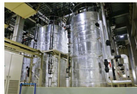
建屋内の電解液タンク
